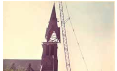
Het transport over de weg was gelukt en hier ziet u hoe de nieuwe torenspits op de kerk wordt getild d.m.v. een enorme hijskraan. Zaterdag 11 augustus 1973. Deze dag was bewust gekozen vanwege het mooie weer en de geringe hoeveelheid wind!
